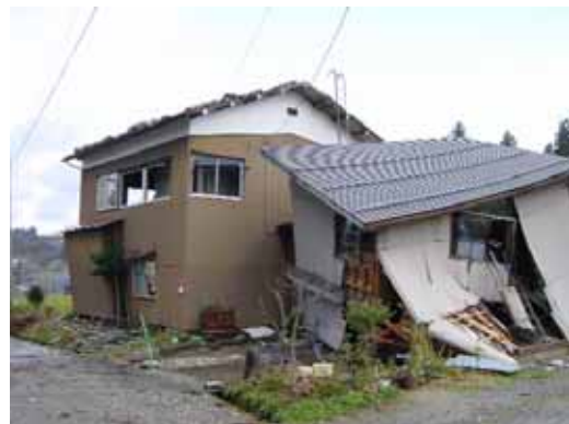
手前の車庫兼倉庫は倒壊（下に自動車あり）
