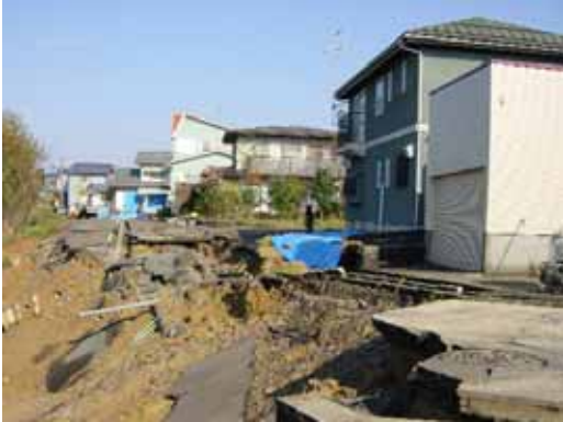
団地西側の道路。数カ所で崩れている
