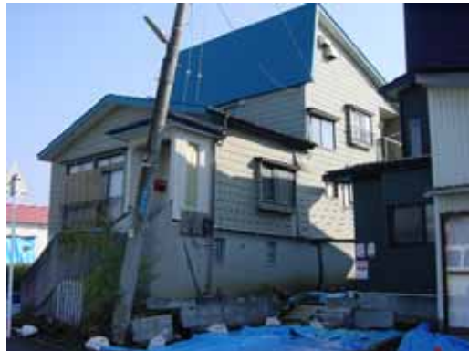
同左。傾いた電柱と住宅
