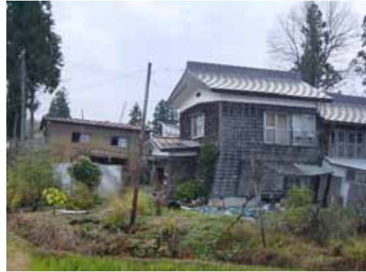
このように傾いた木造建物が多くみられる
