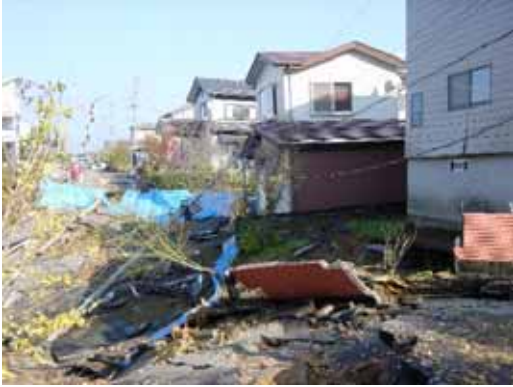
団地南西部の角。地盤が崩れて建物が傾斜
