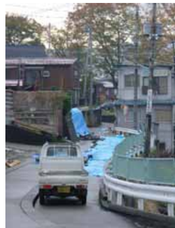
小河川沿いの道路が被害
