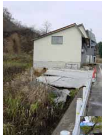
川沿いの宅地部分に被害
