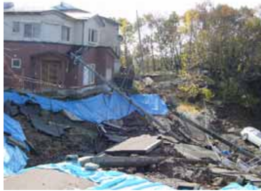
逆側から。道路が完全に崩れ落ちている
