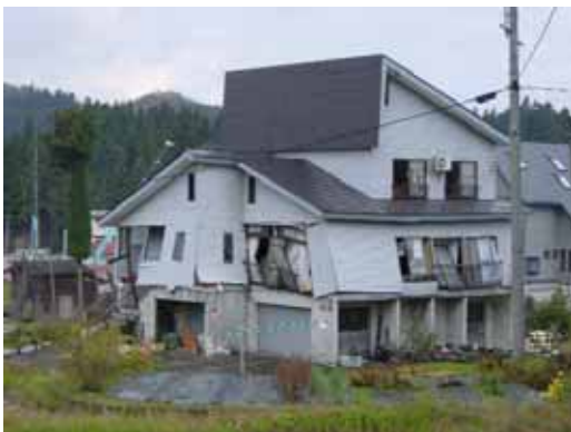
高床コンクリートの上部が全壊、宅地も赤判定
